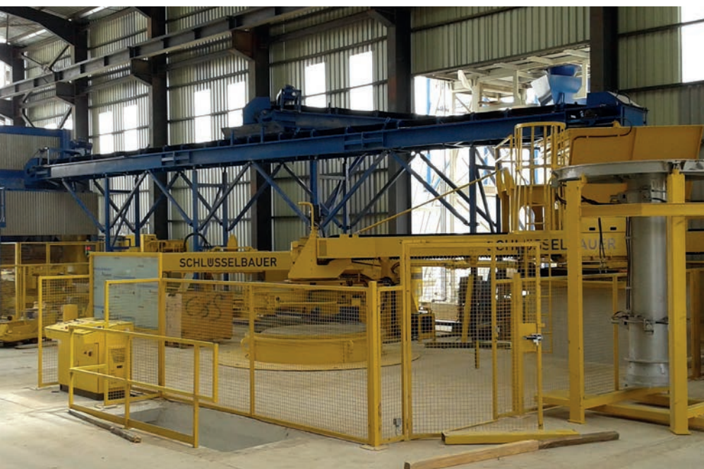
Автоматическая установка Exact XL для производства труб на бетонном заводе алжирской компании Trans-Canal Centre
